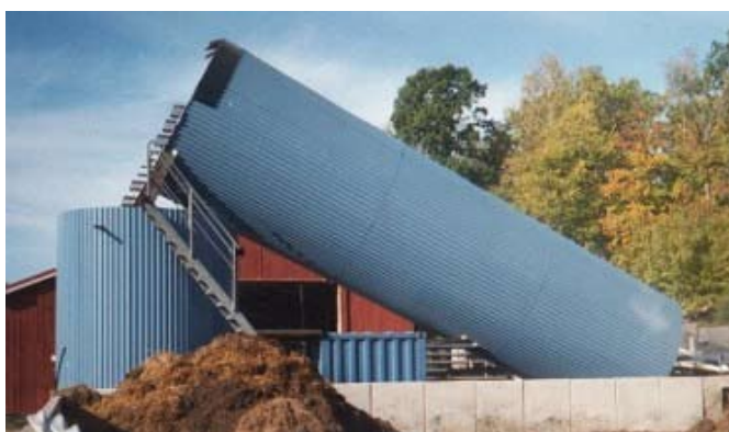
Försöksanläggning för framställning av biogas, Yttereneby gård. Foto: Winfried Schäfer.
